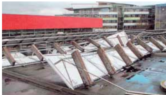
Beispielbild: Durch Kippen beschädigte Modulreihen auf einem Flachdach (unzureichende Beschwerung) Quelle: Fachpresse
